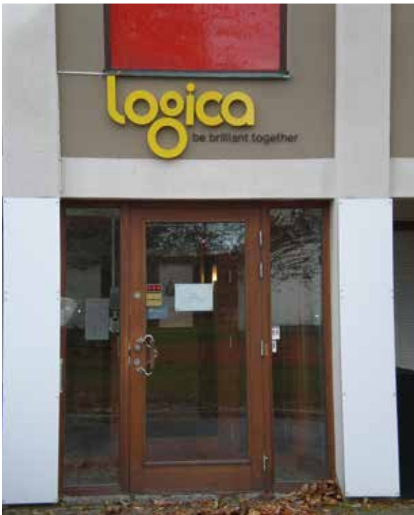
Skylt som är välplacerad vid verksamhetens huvudentré. Kabeldragningen har dock blivit för exponerad.
