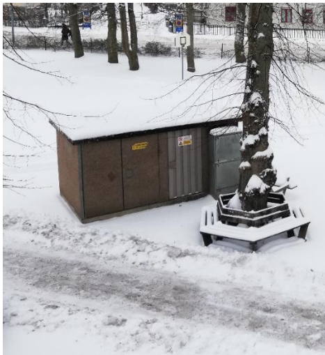
Figur 29. Transformatorstationen sedd från Paviljongens övre våning.
